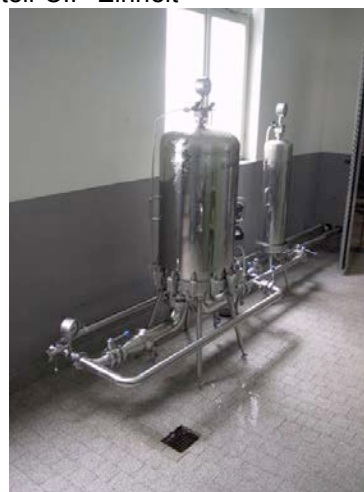
2-stufige Filterpalette - Bierfiltration Filterkerzenanlage nach Kieselgurfilter Anschluss an externe CIP-Anlage
