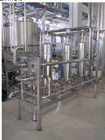
3-stufige Wasserfiltration Filterkerzenanlage mit Anschluss an externe CIP-Anlage
